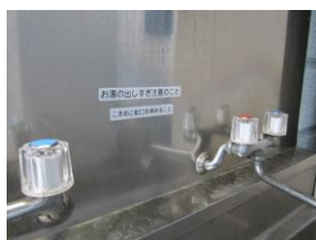
節水・給湯温度調整表示
